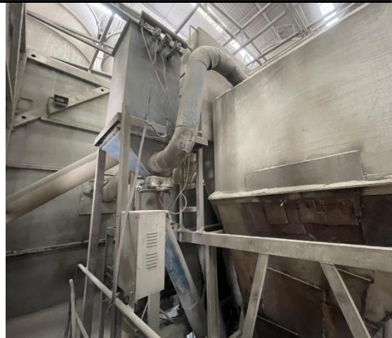
搅拌粉尘除尘器
