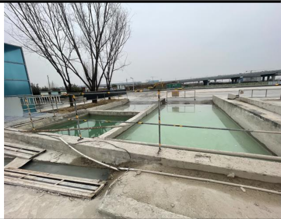
车辆清洗废水沉淀池
