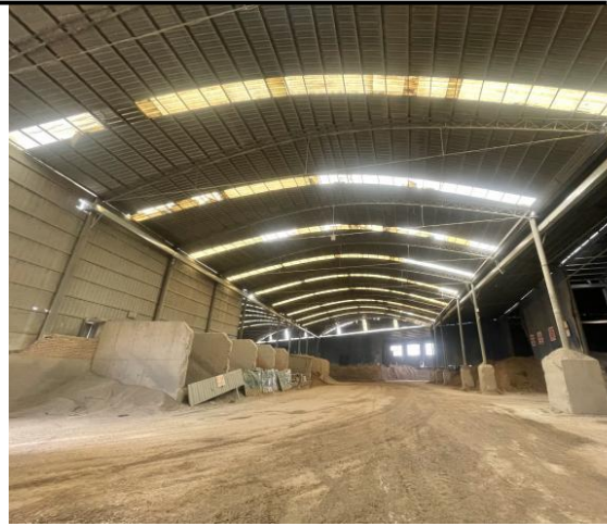
料仓内喷淋设施
